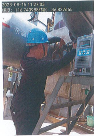
RTO 装置进口
