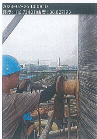
对甲酚硫酸排气筒(DA040)
