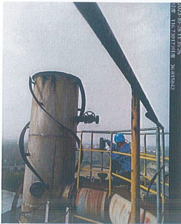
2023-10-28 14:22:17 经度: 116.731658 纬度: 36.817765 炭黑 5#6# 收集袋滤器排气筒 (DA034)
