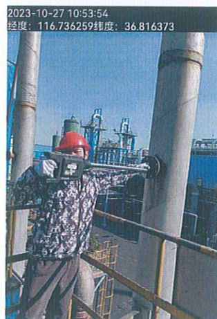
炭黑 5# 再处理袋滤器排气筒 (DA037)
