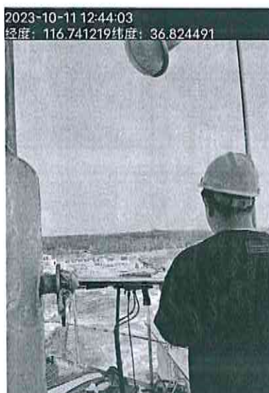
4#燃气轮机组排气筒
